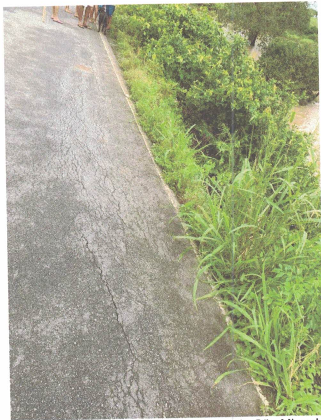
Imagem 14: Pavimento asfáltico com fissuras na ponte sobre o rio São Miguel, no povoado Tapera, AL-450
