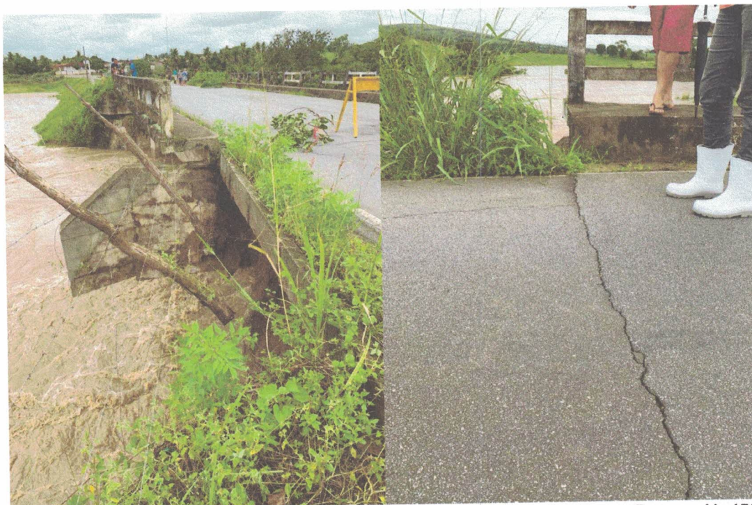
Imagem 11 e 12: Vista superior da ponte sobre o rio São Miguel, no povoado Tapera, AL-450
