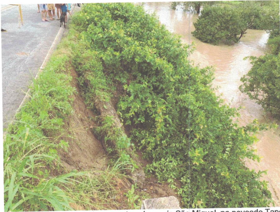
Imagem 13: Parede lateral desabada na ponte sobre o rio São Miguel, no povoado Tapera, AL-450
