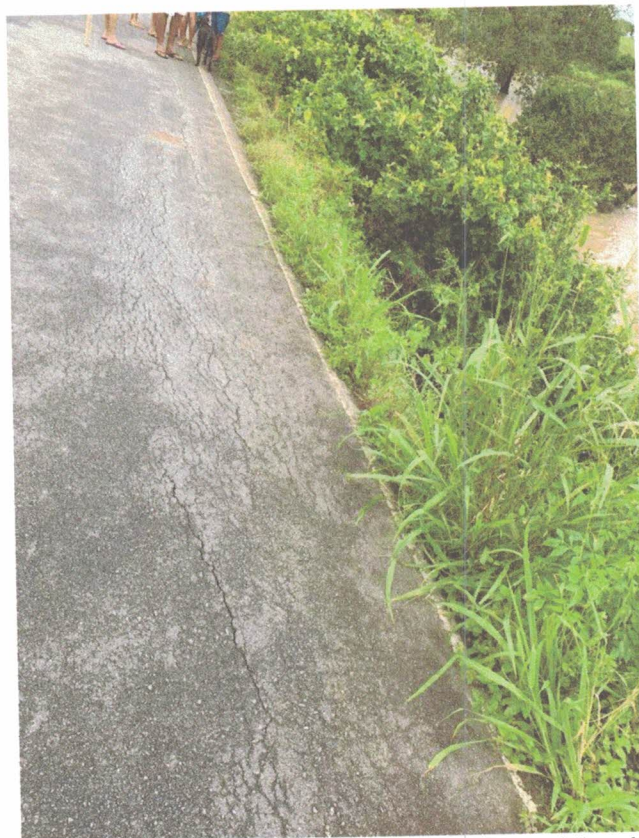
Imagem 14: Pavimento asfáltico com fissuras na ponte sobre o rio São Miguel, no povoado Tapera, AL-450
