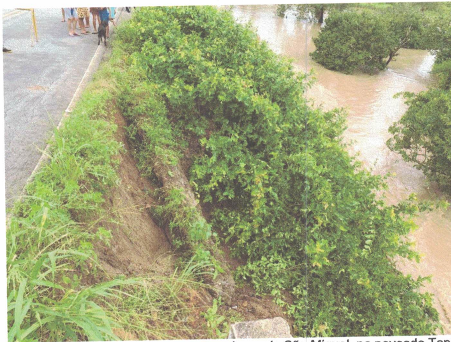
Imagem 13: Parede lateral desabada na ponte sobre o rio São Miguel, no povoado Tapera, AL-450
