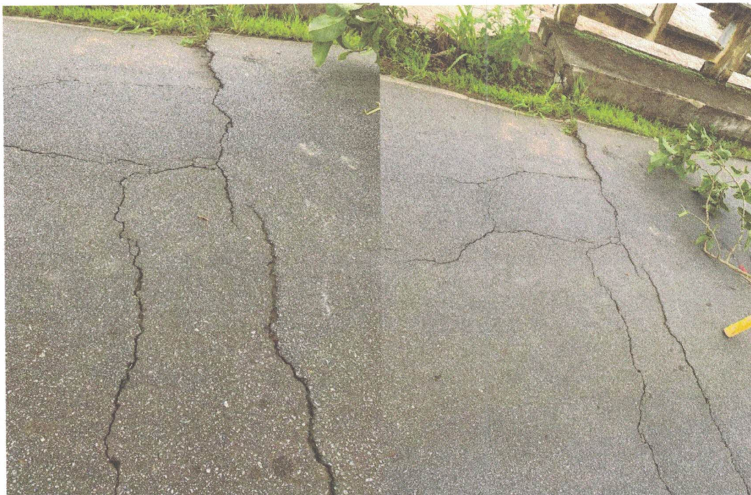
Imagem 7 e 8: Rachaduras na ponte sobre o rio São Miguel, no povoado Tapera, AL-450
